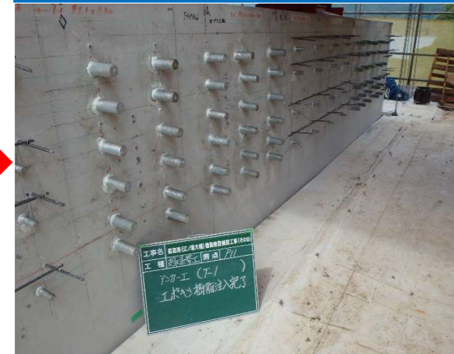
ジャッキアップ受台及び作業構台アンカーボルト設置完了
